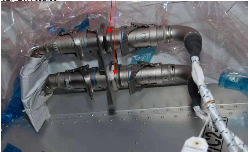
JLP LTA cables
