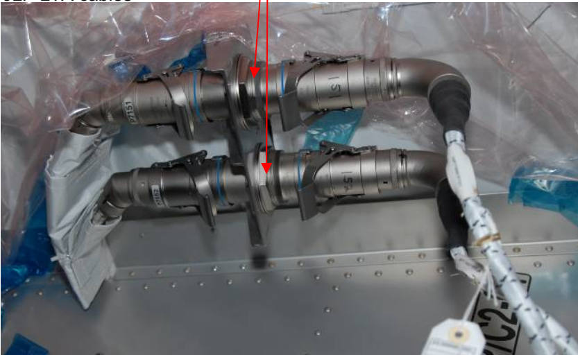
JLP LTA cables
