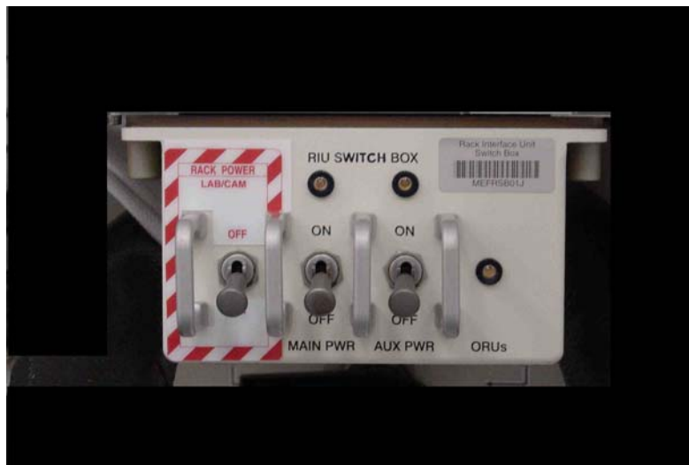
Figure 6.14-1: RIU Switch Box
